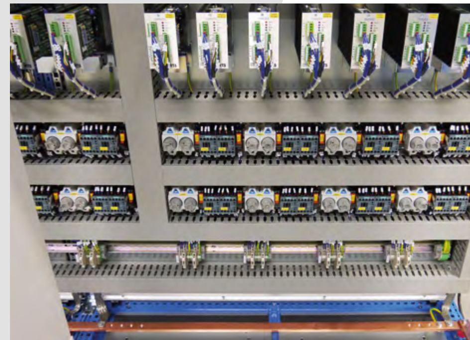
Retrofit bei Lebbing: Sicherung der Zukunftsfähigkeit durch modernste Antriebsregelung.
